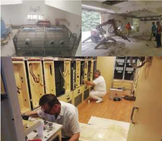
Původní tlakové komory byly postupně rozebírány; částečně kvůli recyklaci některých komponentů, částečně kvůli bezpečnosti.
