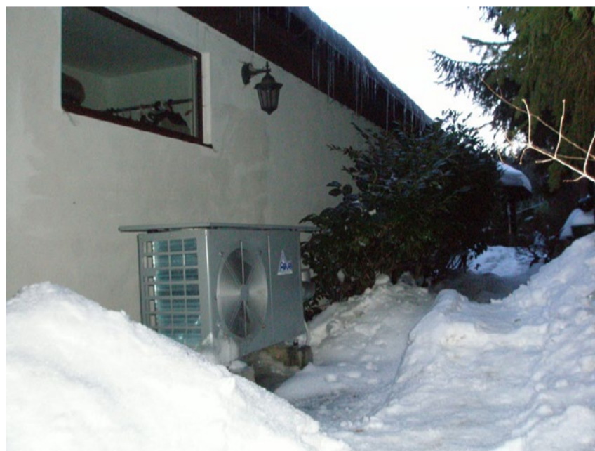
Ukázka realizací tepelného čerpadla např od firmy 4T, a. s.
