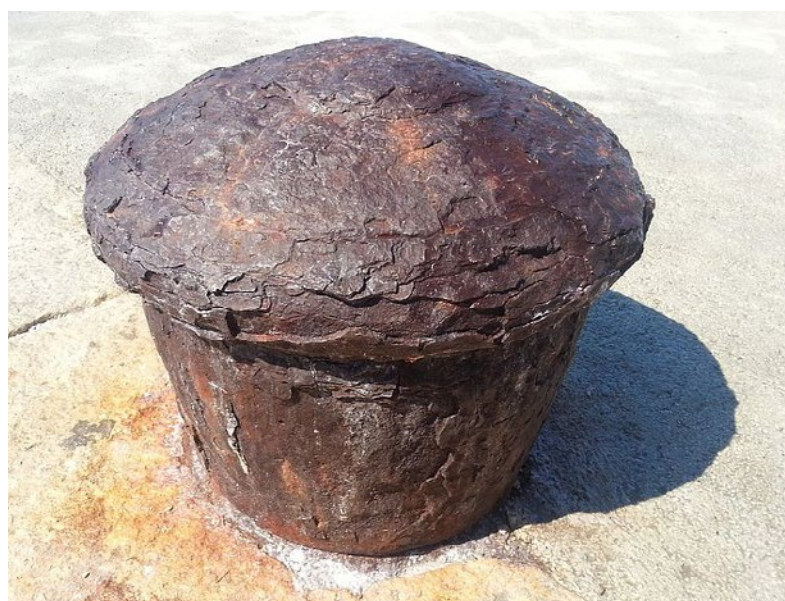
Chemická koroze – působení vzdušného kyslíku, kyselin, louhů a solí
