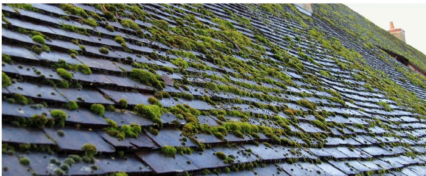
Důsledky dlouhodobého působení vlivů okolí na povrch střechy
