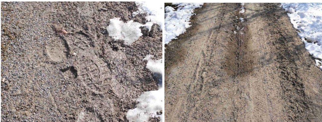
Obr. 7 Mlatový povrch poškozený při jarním tání sněhu
