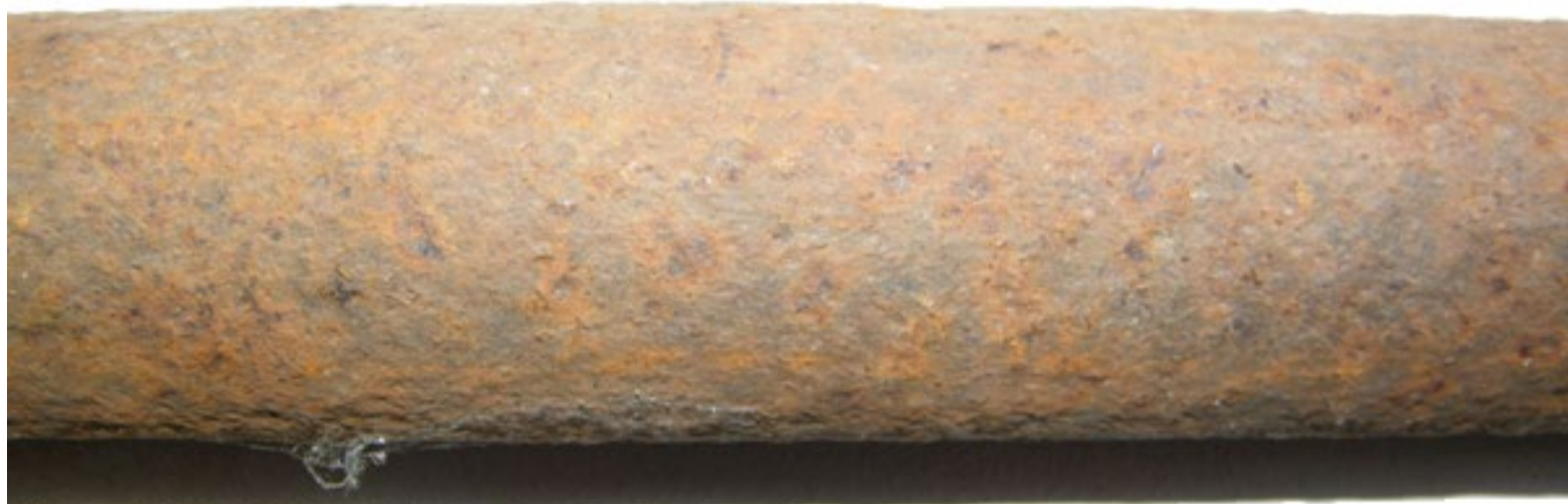
Rez na ocelové trubce, pravděpodobně nejznámější forma koroze
