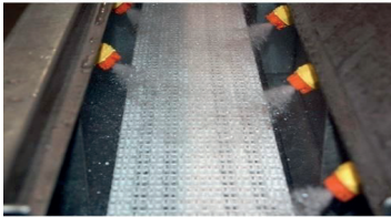
Abb. 5.15 Beispiel für die Kühlung mit Wassersprühnebel
