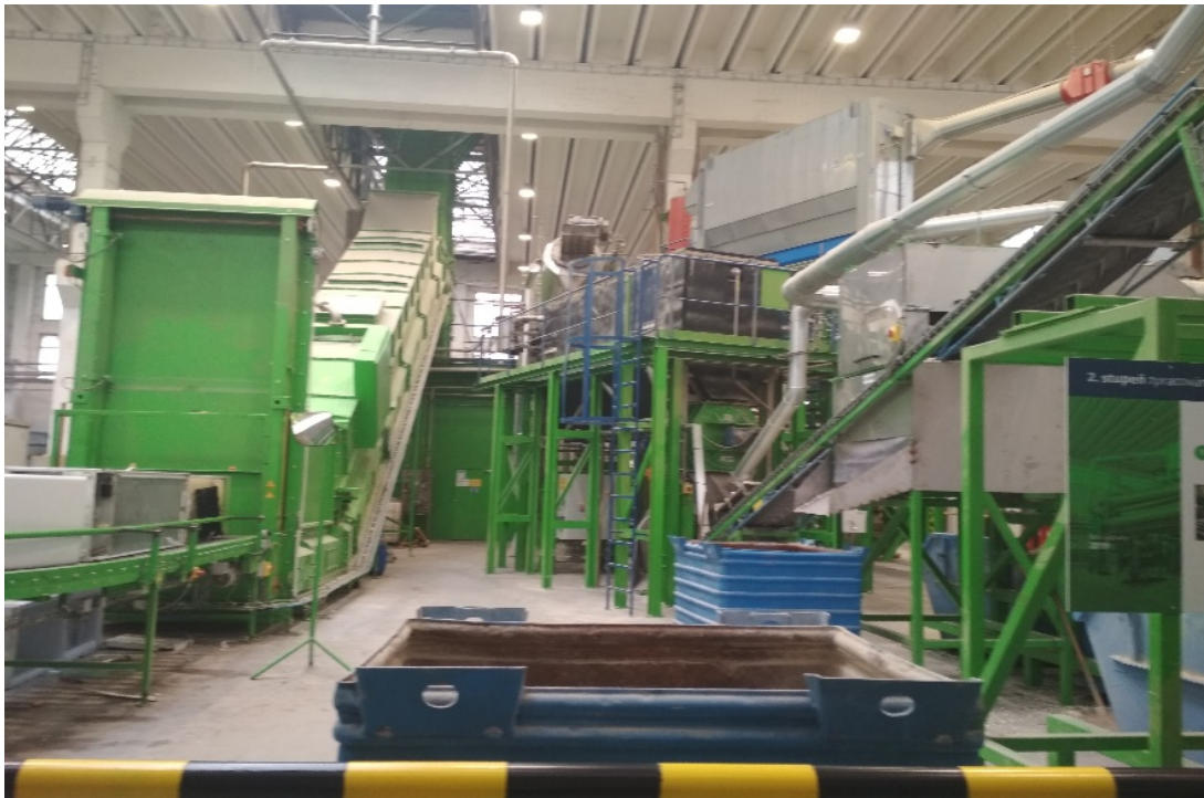
Obrázek 4: Zařízení ke zpracování EEZ (použité lednice), drcení plastů a separace kovů ve Stráži pod Ralskem; PRAKTIK Solution s.r.o.
