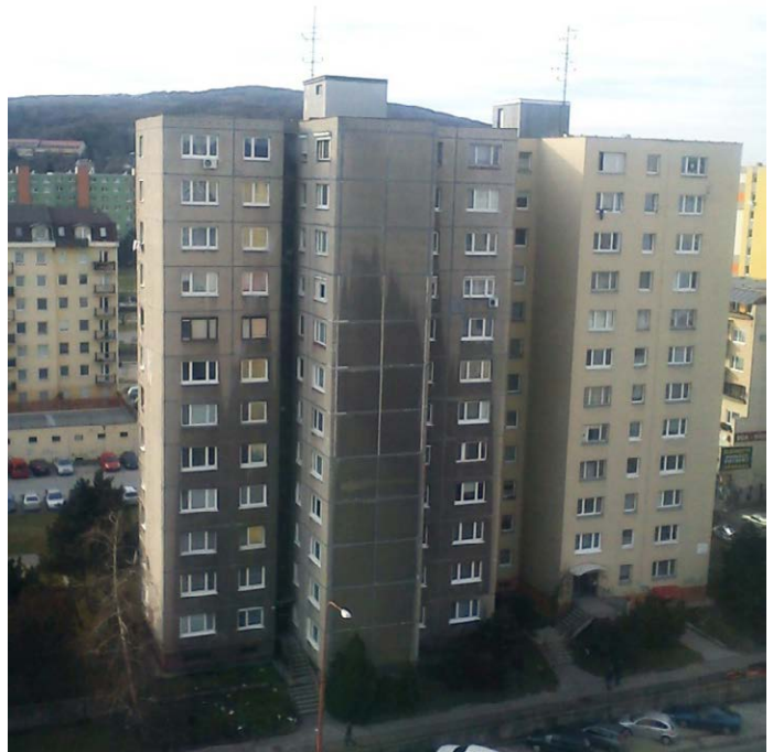
Obr. 98: Fasáda panelového bytového domu vystavená účinkom vetrom hnaného dažďa
