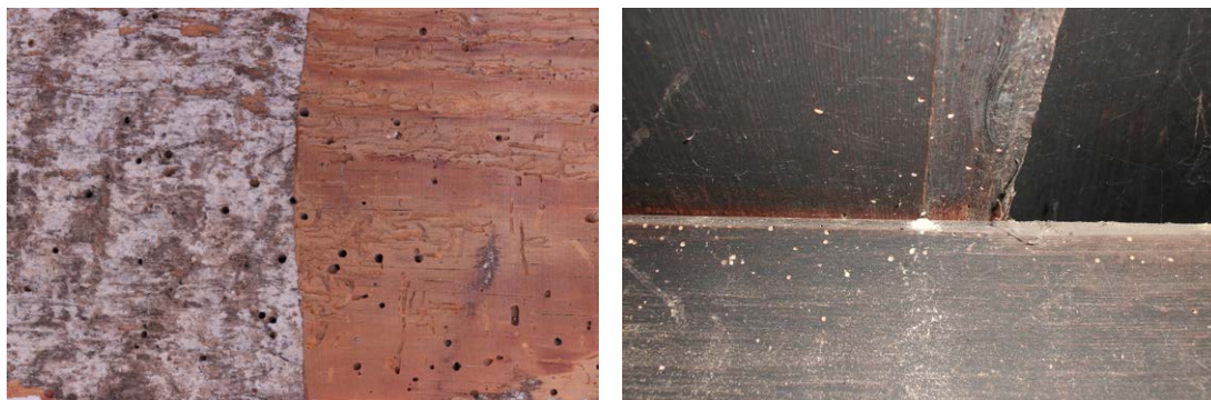
Obr. 36: Výletové otvory a požerky (vlevo) a typické poškození dřevěného stropu (vpravo) červotočem proužkováným
