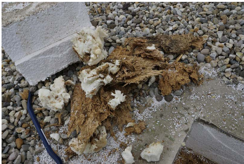
Obr. 74: OSB doska umiestnená pod parozábranou v rámci plochej strechy, konečné štádium jej rozpadu, pri odbere vzorky sa rozpadáva na jednotlivé kusy
