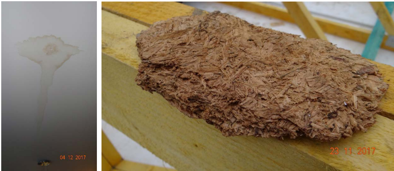
Obr. 68: Prejavy kondenzácie v interiéri na podhlade a voľne rozoberateľný záklop z OSB dosiek
