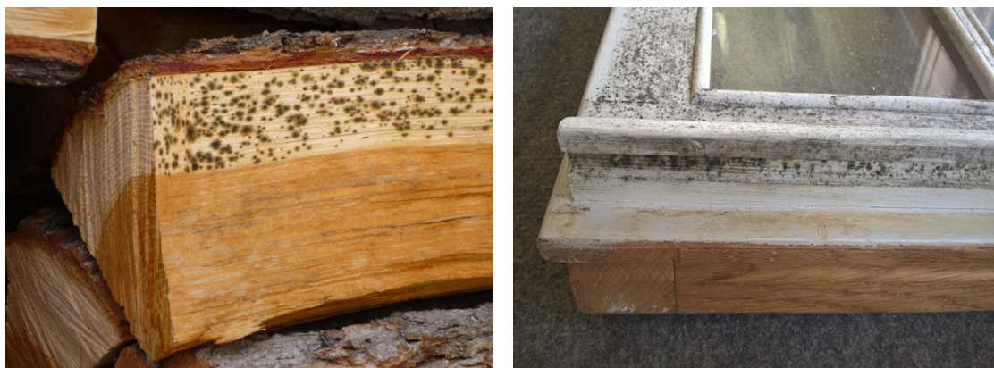
Obr. 27: Plísně rostoucí v bělové zóně dubového dřeva (vlevo) a na exteriérové straně povrchově upraveného okna (vpravo)
