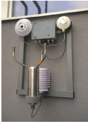
Obr. 108: Pohľad na fasádnu meteostanicu pozostávajúcu z ultrasonického anemometra, pyranometra, pyrgeometra a integrovaného snímača teploty, relatívnej vlhkosti a tlaku vzduchu
