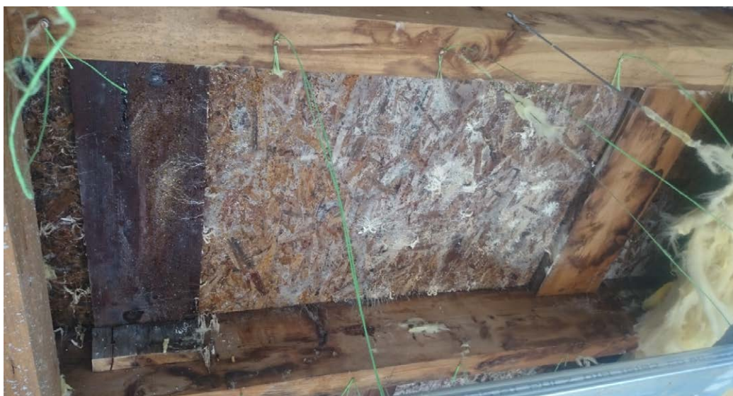
Obr. 78: Pohľad na OSB dosku záklopu kompletne pokrytú hubami a znateľne mokrú stužujúcu fošňu
