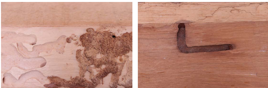
Obr. 35: Povrchové požerky tesaříka polokrovového (vlevo) a hákovitá chodba tesaříka dubového (vpravo)
