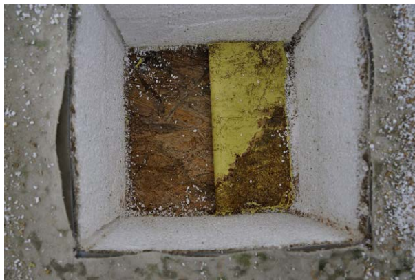
Obr. 65: Pohľad na OSB dosku ako plný záklop na stropniciach a degradačný proces spôsobený parozábranou medzi vrstvami tepelnej izolácie nad a pod doskou
