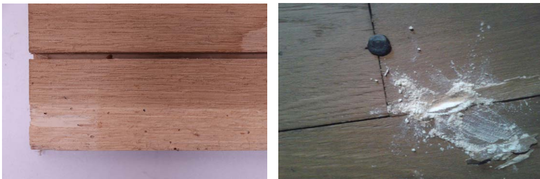
Obr. 37: Výletové otvory v běli dubu (vlevo) a typické poškození dubové podlahy (vpravo) hrbohlavem parketovým
