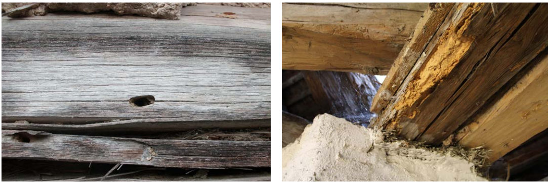
Obr. 34: Výletový otvor (vlevo) a typické poškození trámů (vpravo) tesaříkem krovovým
