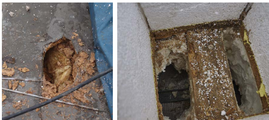
Obr. 61: Použitie OSB dosky ako debnenie a nosný podklad pod parozábranu pri kombinácii tepelnej izolácie nad aj pod parozábranou: hniloba na OSB doske a takisto na hornej strane stropníc (vpravo)
